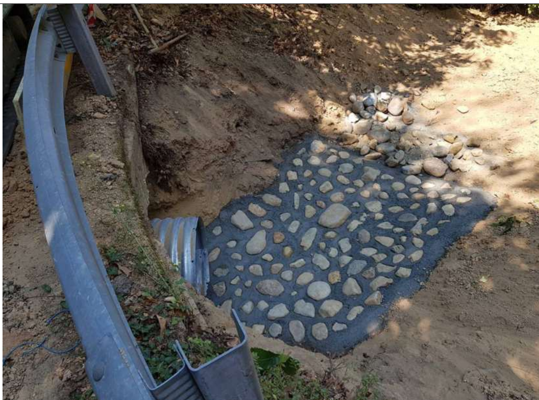
Realizzazione lavori: realizzazione massetto in cls misto pietrame di diversa pezzatura al fine di limitare l'azione erosiva delle acque defluenti, immediatamente a valle dell'uscita del Finsider
