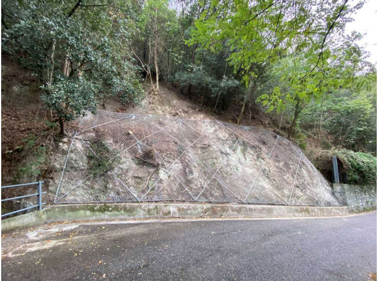
Realizzazione intervento: rafforzamento corticale con posa di reti e disaggio della parete interessata
