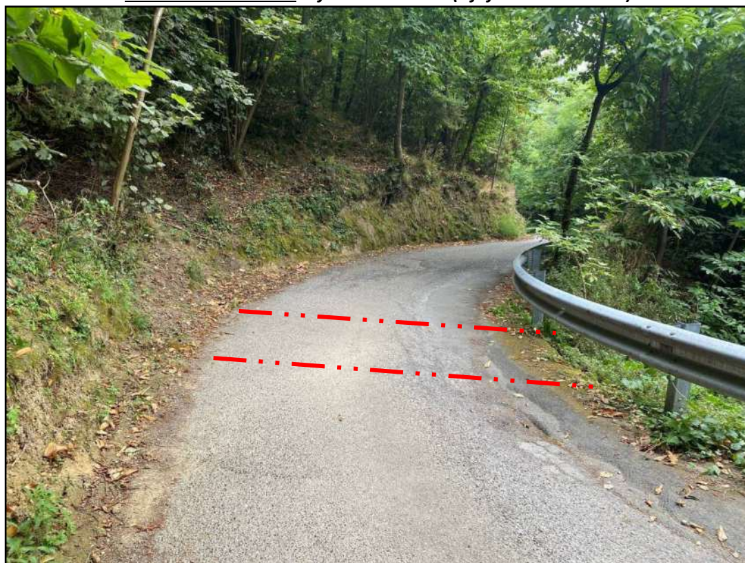
Stato dei luoghi antecedente lavori Foto n. 16 – Traccia tubazione tipo Finsider per convogliamento acque su Rio catastalmente censito
