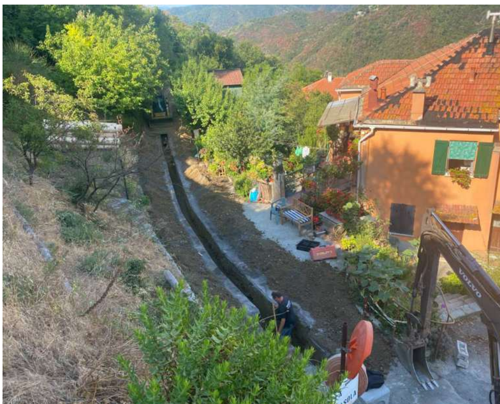
Realizzazione lavori: fasi esecutive scavo a sezione ristretta per posa in opera canalizzazione di regimazione acque nel tratto
